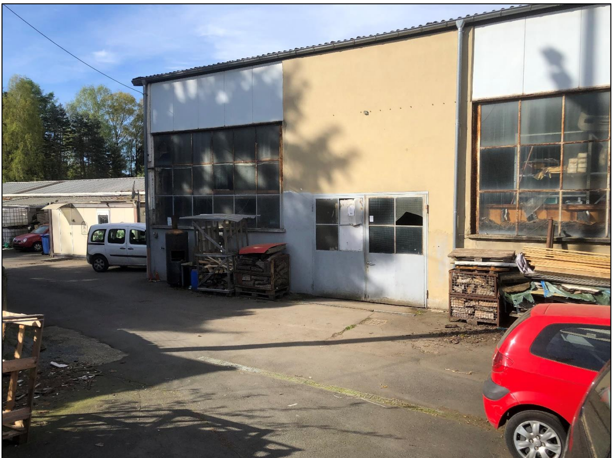
Abb. 6: Bestandgebäude mit Einflugmöglichkeiten durch defekte Verglasung (IBU, 11.04.2024)
